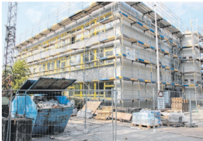
Die Fassade des Schwanenseegebäudes ist noch eingerüstet. Auch der Aufzugschacht (rechts) ist noch leer. Innen und außen wird gleichzeitig gearbeitet. Fotos: Christine Hofmann
