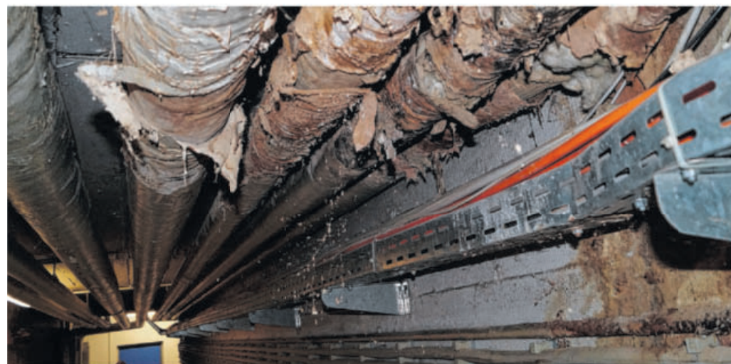
Dringender Sanierungsbedarf am ASG: Im Untergeschoss des Hauptbaus ist der schlechte Zustand der Leitungstrassen nicht zu übersehen. Foto: Roth und Partner Architekten
